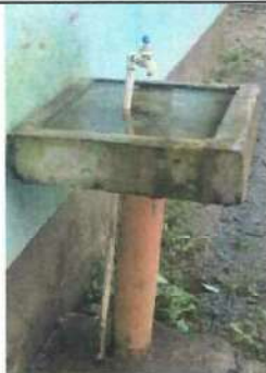
Foto 3: El lavamanos para los niños de primaria esta dañado por lo que se realizará sustitución por otro de concreto
