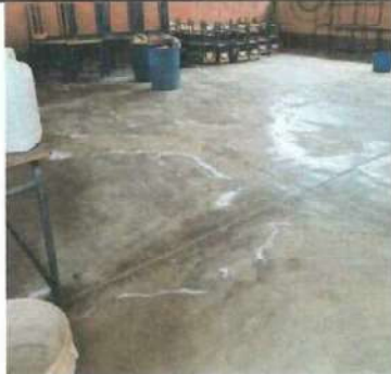
Foto 1: El establecimiento cuenta con piso liso deteriorado, por lo cual se realizará la sustitución por piso cerámico en todas las aulas de primaria
