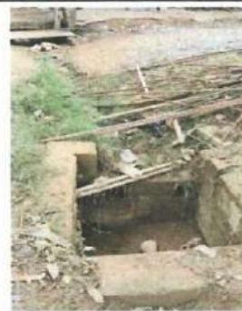
Foto 4: la tubería de drenaje hacia los sanitarios se encuentra deteriorada lo que ocasiona fugas
