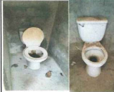
Foto 2: Los servicios sanitarios del nivel primario ya no son funcionales por lo que es necesaria su sustitución
